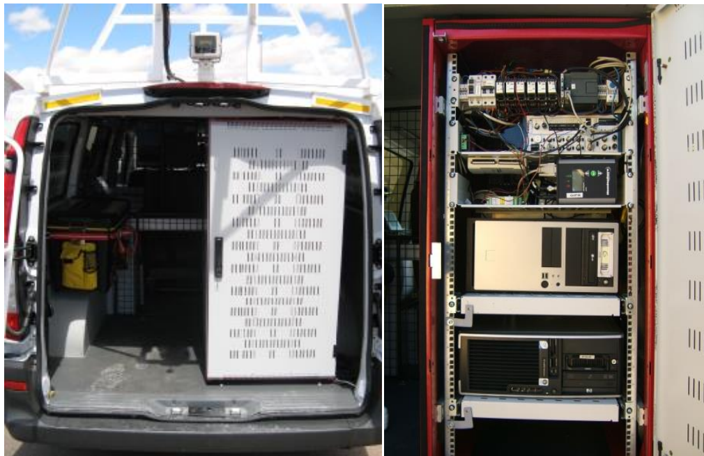
Ilustración 9. Rack contenedor del sistema informático
